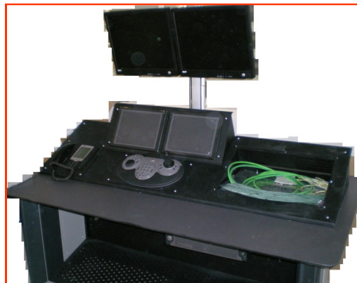
Consola de operador con todos los dispositivos de control a mano: intercomunicador, pantalla de control de mecanismos, monitores de cctv, pupitre de operador de interfonía.
