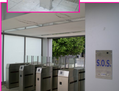
Los vídeo-interfonos IPFON se instalaron tanto en poste como empotrados.
