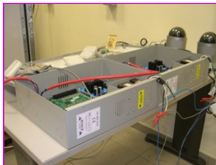
Electrónica de control del sistema de control de accesos durante las pruebas FAT
