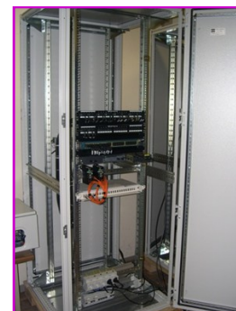
Armario rack con electrónica de red y repartidores de cobre y fibra óptica
