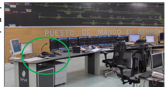
Nuevas instalaciones de El Berrón. Señalados se pueden ver el aplicativo y el terminal único.
