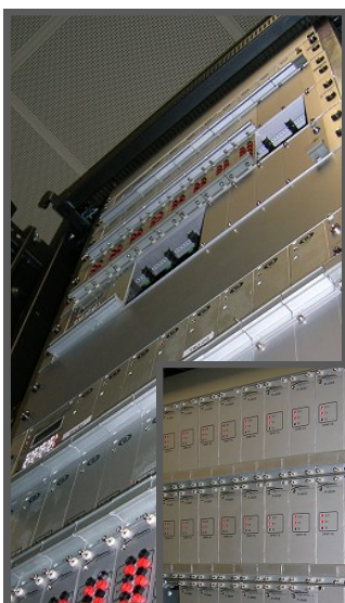
Armarios de servicios de telefonía selectiva y hardware de adaptación
