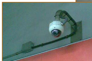
Aspecto de un domo instalado en una estación.
