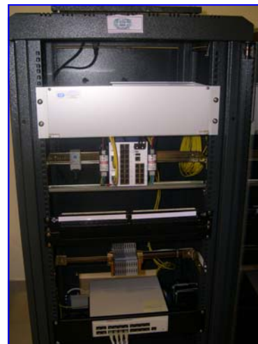
Armario rack de Mashtul con todos los equipos de telefonía y datos así como los repartidores de fo y audio durante las pruebas FAT en Revenga.
