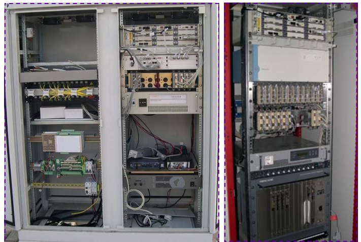
Aspecto de los armarios de parada y PCC
