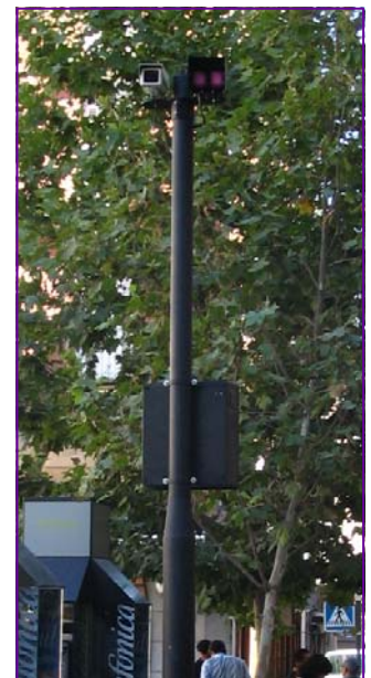
Conjunto de elementos por punto de control: poste, cámaras color e IR, armario de comunicaciones e interfonía.
